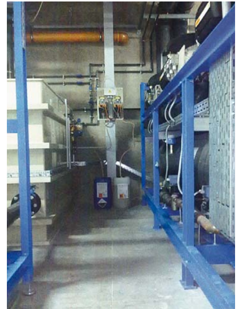
Biozid und Korrosionsschutzmittel werden automatisch dosiert, um das Kühlwasser zu konditionieren. Grobe Verschmutzungen entfernt der Rücklauffilter
