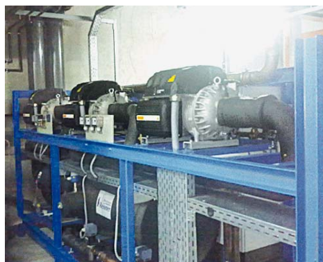
Drei Epsilon-Verdichter bringen Kälteleistung nach Bedarf
