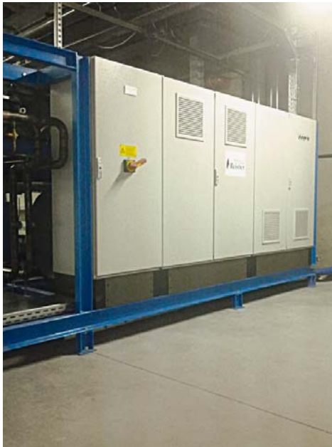
Saubere Regelung: Im Reisner-Schaltschrank sind alte Anlagen und Systemerweiterung sinnvoll integriert
