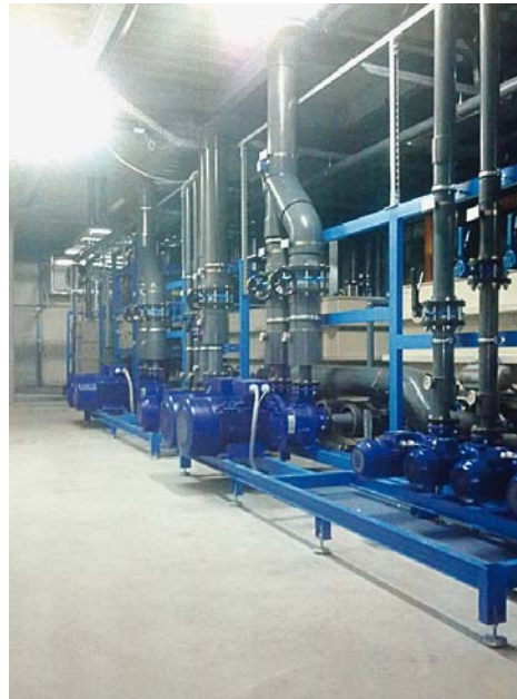
Neue Pumpen beim Anwender, auf der Werkzeugseite mit Frequenzumrichtern geregelt, versorgen die Produktion
